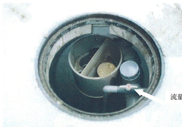
流量調整槽計量装置
