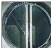
固液分離槽移流部
