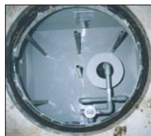
ばっ気循環処理槽 第2室
