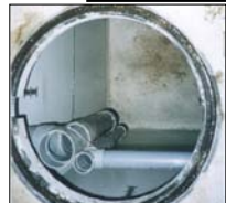
固液分離槽流入部
