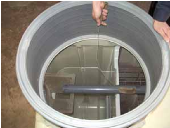
移送管の洗浄例
