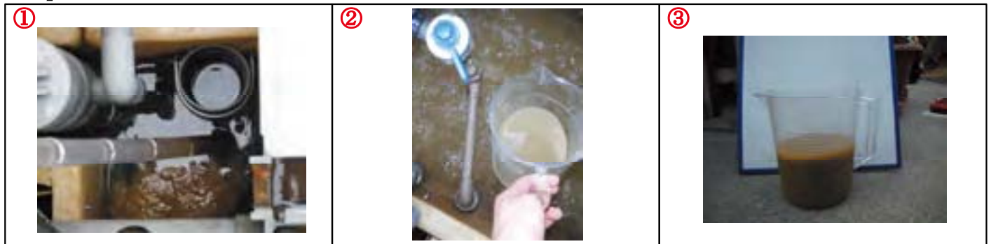
① 処理水槽の堆積汚泥厚 30cm(多い)
