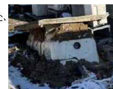
能登半島地震により被災した浄化槽
